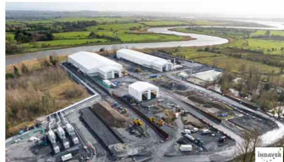
Überdachung für Bodensanierungen
