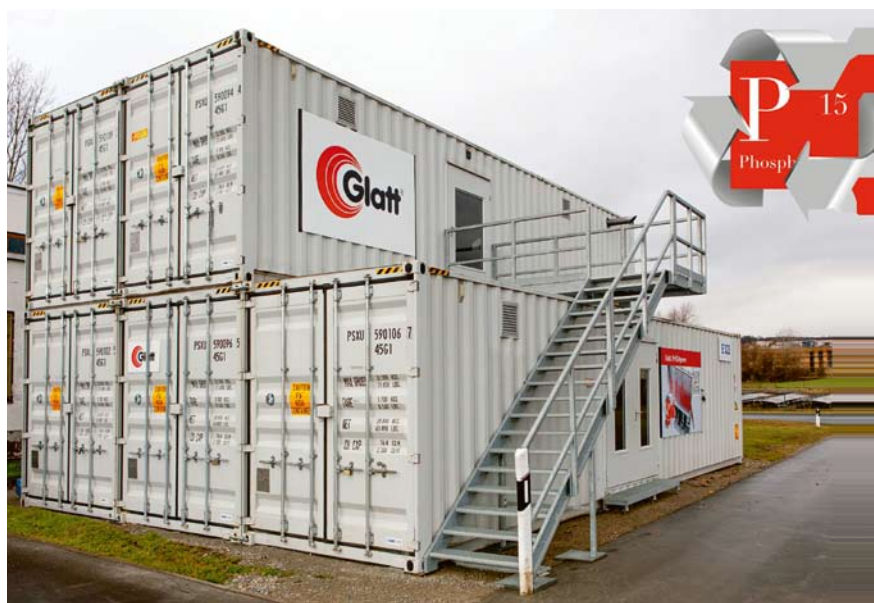
Containeranlage zur Schwermetallabreicherung von Klärschlamm-Aschen
