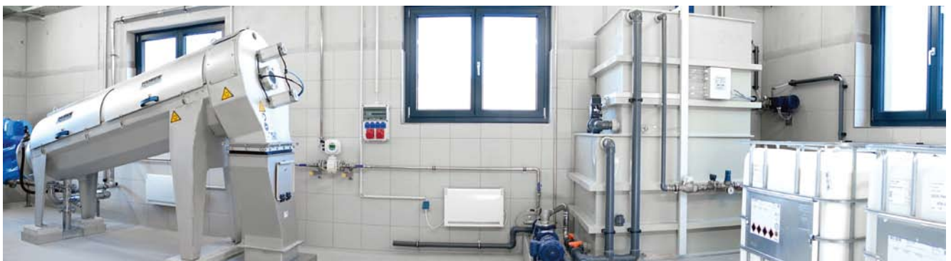
HUBER Schneckenpresse Q-PRESS® 440.2 auf der Kläranlage Parsberg
